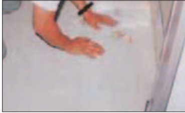
下地処理(清掃・油脂分・石鹸かすの除去等) ※FRP等の下地は必要に応じてプライマーを塗布
